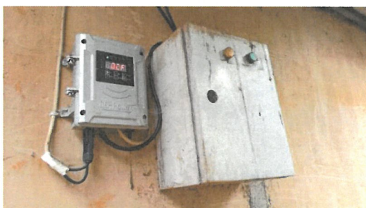
Batteria ed inverter dei pannelli solari
