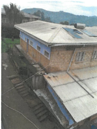
I pannelli installati in diversi punti del centro
